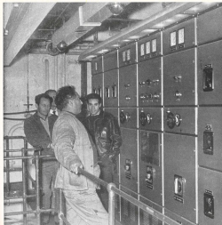
L'equipaggiamento della nave in prova (sopra) e il quadro elettrico principale.
