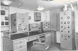
Sopra e a sinistra: due aspetti del locale R.T.
